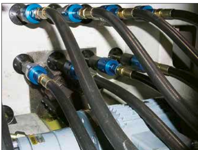
Złącza samonośne DEUBLIN 1116 na linii obróbkowej w fabryce podzespołów samochodowych
